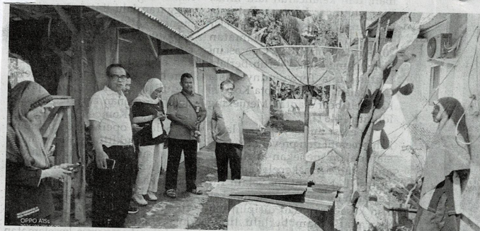
KERUSAKAN GEDUNG — Kepala Kantor Kementerian Agama Kota Pariaman, H. Rinalfi beserta pejabat lainnya menerima kunjungan tim dari Dinas PUPR Kota Pariaman, yang melakukan penilaian kerusakan gedung kantor Kemenag.
